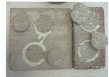
Fotografía 4.- Detalle despegue soporte de hormigón
